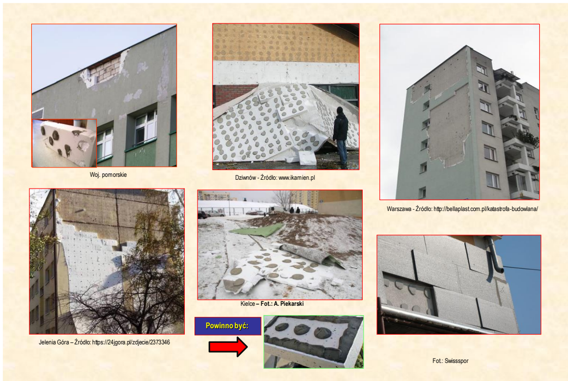
Fot. 13÷18 Skutki błędów wykonawstwa prac dociepleniowych
