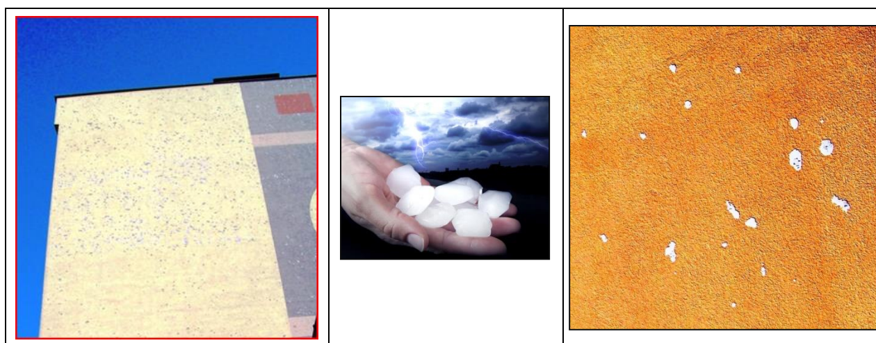
Fot. 1 Uszkodzenia elewacji po gradobiciu spowodowane zastosowaniem nieodpowiedniego systemu dociepleń
